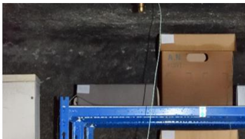
Boîtes en carton exposées juste sous la tête de diffusion du brouillard d'eau se sont imprégnées d'eau.
